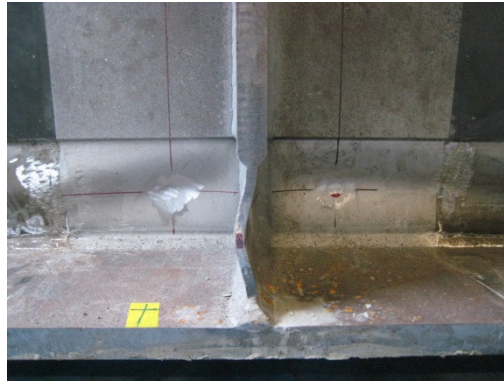
図-4.1 支点部垂直補剛材の局部座屈
