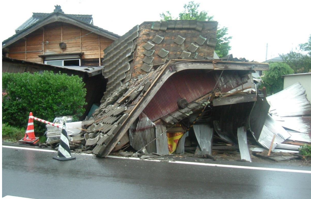
Fig.4-1 新潟県中越地震で倒壊した軸組工法の一階建て家屋 地震により瓦が落ちているが、屋根や梁が残っているのが確認できる。 (長岡市消防本部の御厚意により提供いただいた画像。許可なく転載を禁じる)
