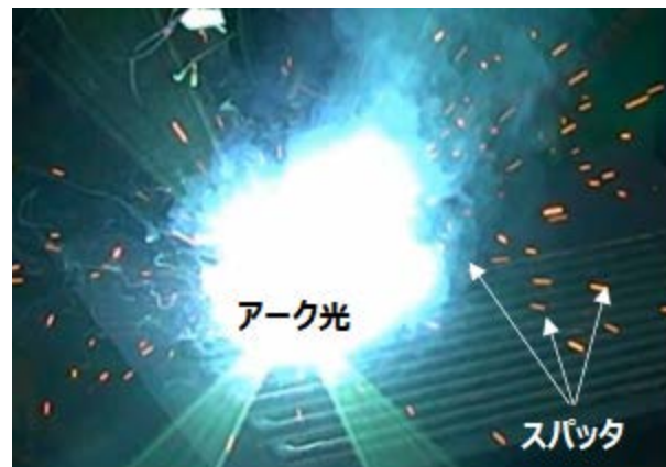
図 1-1 アーク溶接スパッタ飛散の様子
