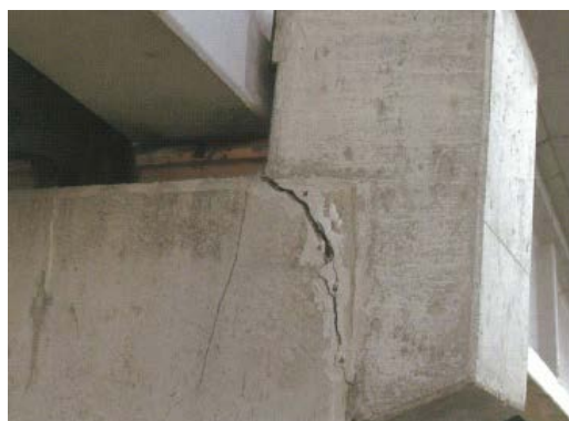
図 2-21 移動制限装置の損傷 49)
