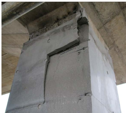
図 2-26 修復後に損傷した事例
