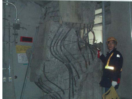
図 2-23 せん断破壊した柱の状況 50)
