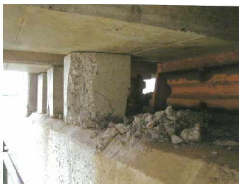
図 2-20 落下防止ブロックの損傷 49)
