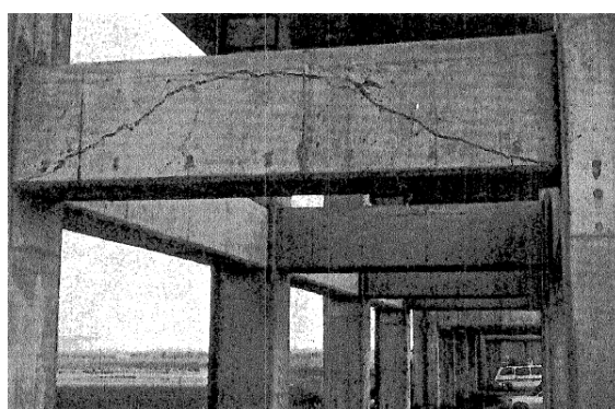
図 2-17 中層梁のせん断ひび割れ 1)
