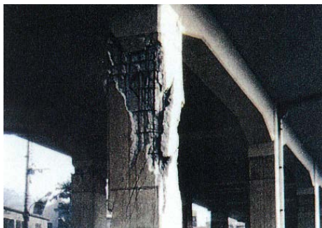
図 2-2 兵庫県南部地震により損傷した柱の例 2)
