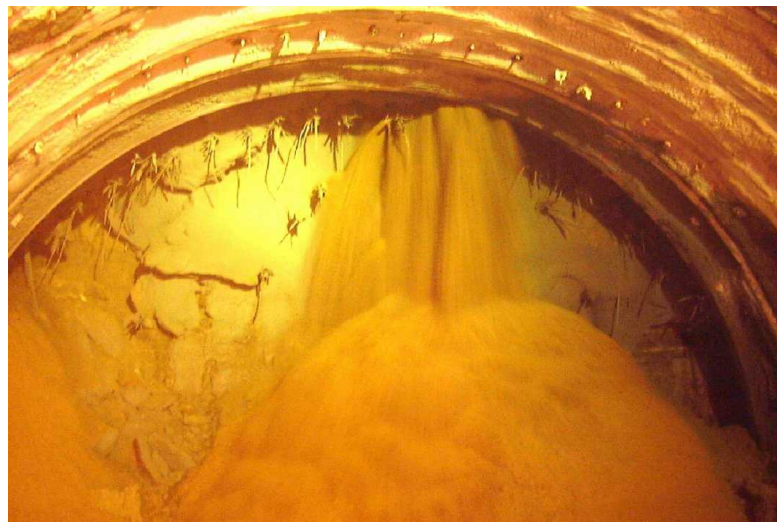
写真 1-1 切羽崩落状況 12)
