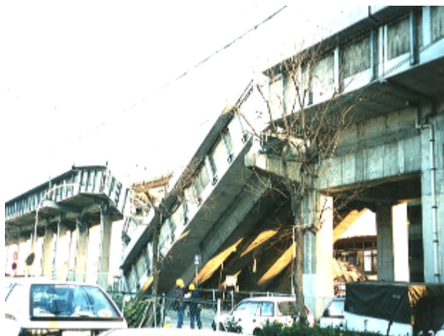
写真2.1.9 RCラーメン構台の崩壊による桁の落橋（松林寺架道橋）
