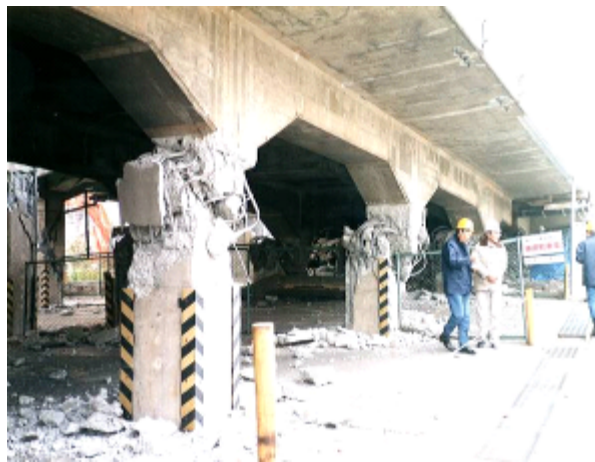
写真2.1.5 RCラーメン高架橋の崩壊（第2御影高架橋）
