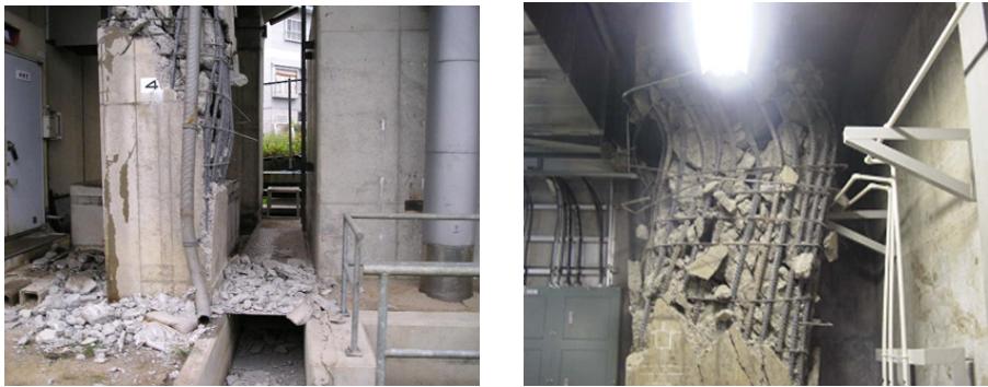
写真 2.1.13 新潟県中越地震の被害（柱部材のせん断破壊）
