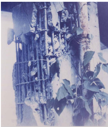
写真2.1.1 ラーメン高架橋の被害状況
