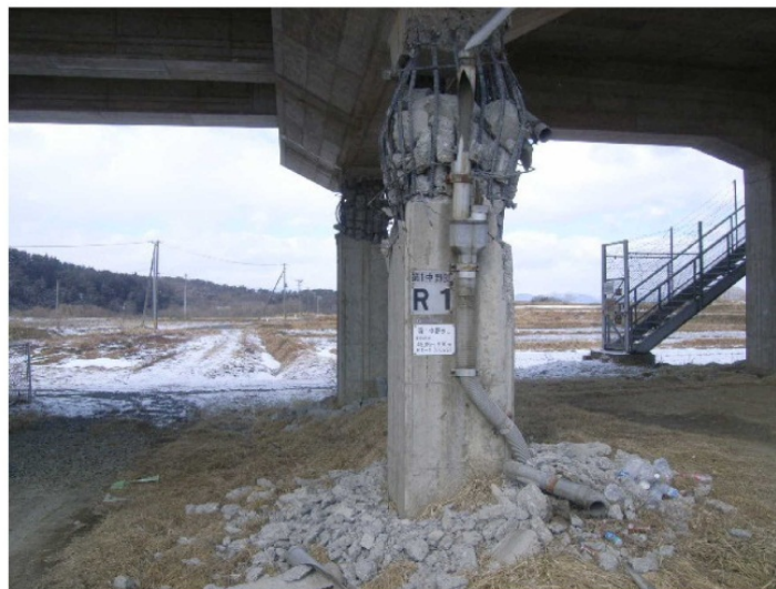
写真 3.1.3 N n 高架橋の損傷状況（起点側）
