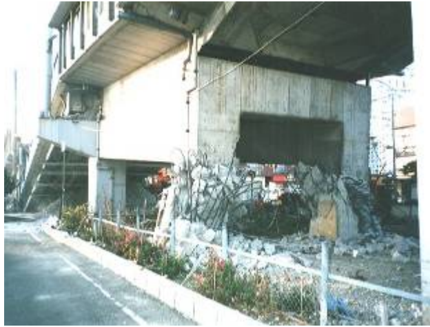
写真2.1.7 RCラーメン橋台の被害状況（阪急今津線線路橋）
