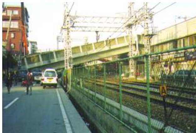
写真2.1.8 RCラーメン構台の崩壊による桁の落橋（阪急今津線線路橋）
