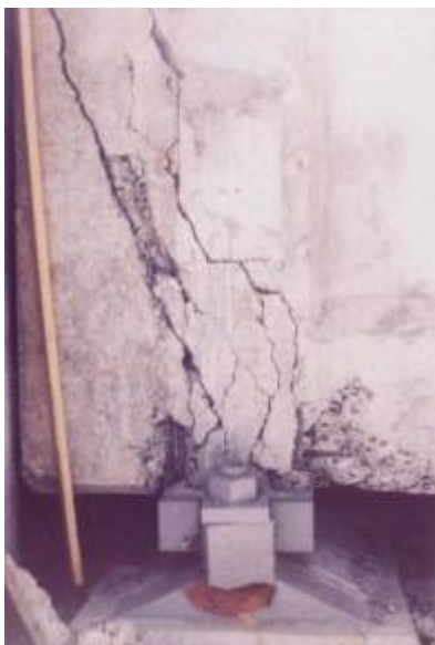
写真2.1.3 コンクリート桁の損傷状況
