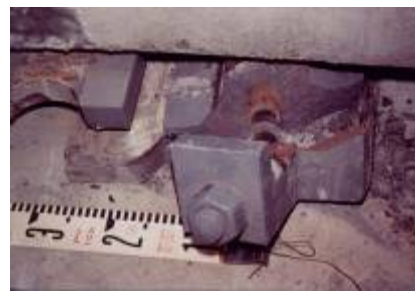
写真2.1.4 支承部の損傷状況
