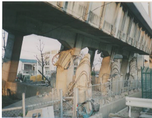
写真2.1.6 RCラーメン高架橋の崩壊（阪水高架橋）
