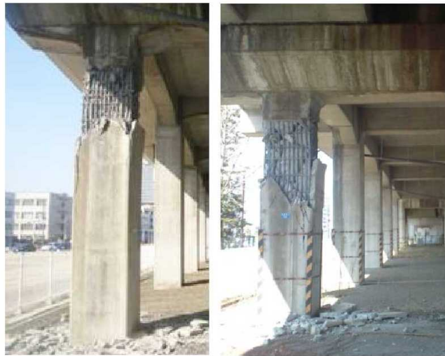
写真 3. 3. 1 端柱の損傷例（起点方より撮影）
