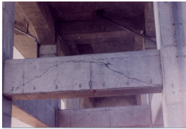
写真2.1.2 中層梁のせん断損傷
