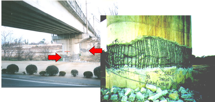
写真2.1.11 橋脚の被害状況（武庫川橋りょう）
