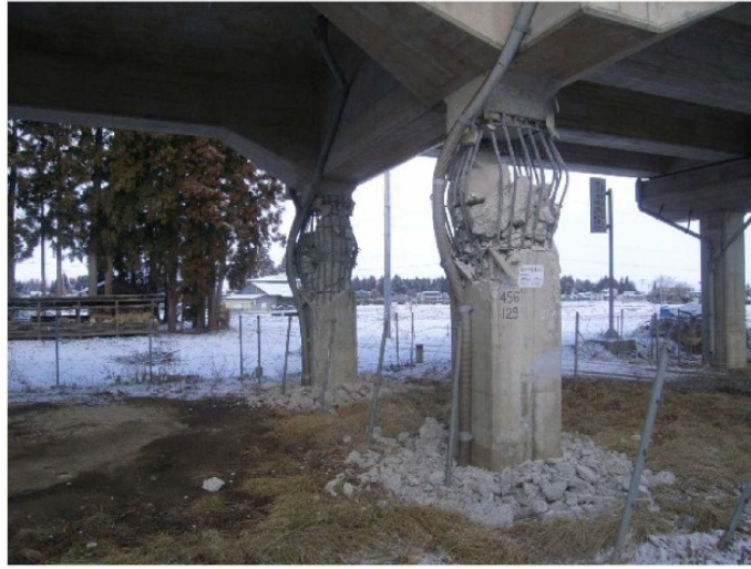
写真 3.1.2 N s 高架橋の損傷状況（起点側）
