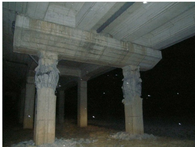
写真 3.1.1 Od高架橋の損傷状況（起点側）
