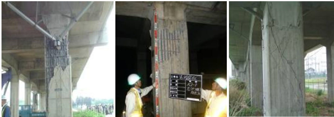
（せん断ひび割れとかぶり コンクリートの剥落）
