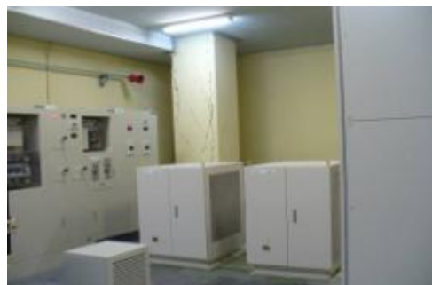
写真 5.1.2 鉄道運行上移転困難な設備に囲まれる既設 RC 柱が損傷した例
