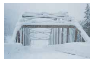
Foto 3. Puente de arco con acumulación de nieve
