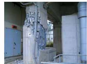
Foto 2. Fractura inducida por un terremoto en un pilar del Shinkansen
