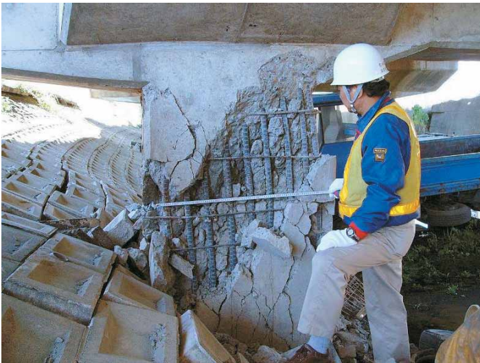
中越地震（2004）の新幹線高架橋の被害
