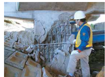
Daño a un puente de Shinkansen elevado desde el terremoto de Chuetsu (2004).
