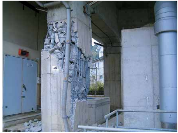
写真2 新幹線橋脚の地震による破壊
