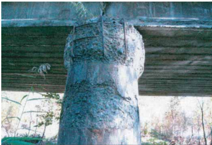
凍害で劣化した橋脚
