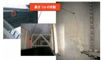
Foto 2. Puenete de Yamazoe (grieta de fatiga)
