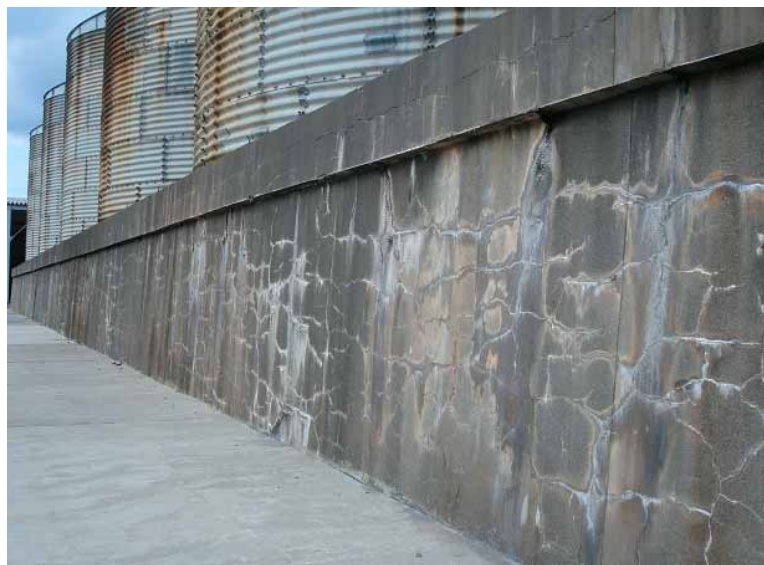
アルカリ骨材反応が生じた擁壁 ようへき
