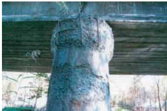
Muelle que revela el daño de las heladas
