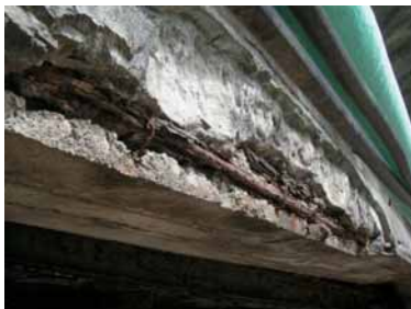
Vista desde abajo de un puente dañado por ataque de cloruro
