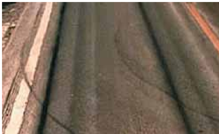
図1 かなりひどいわだち掘れ
