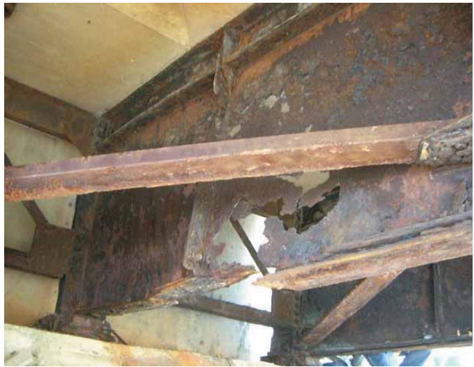
写真3 辺野喜橋（腐食）
