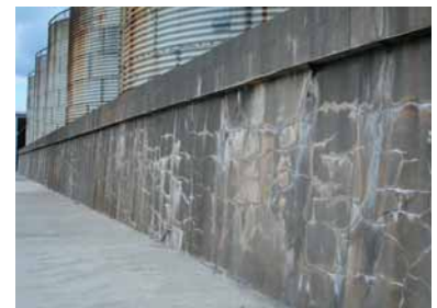
Muro de contención que exhibe los efectos de la reacción álcali-sílice
