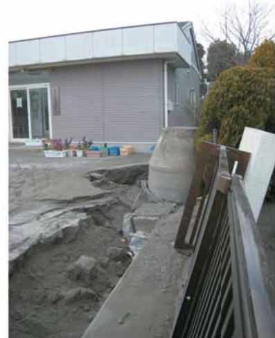
(b) 浮き上がったマンホール
