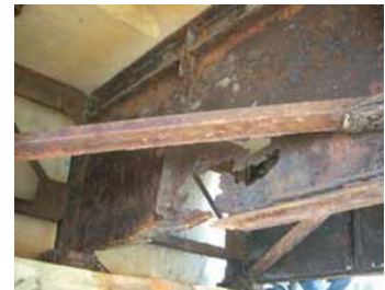
Foto 3. Puente de Benoki (corrosión)
