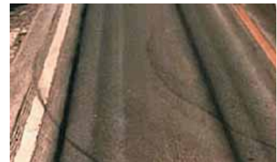
Figura 1. Los ahuellamientos considerablemente serios
