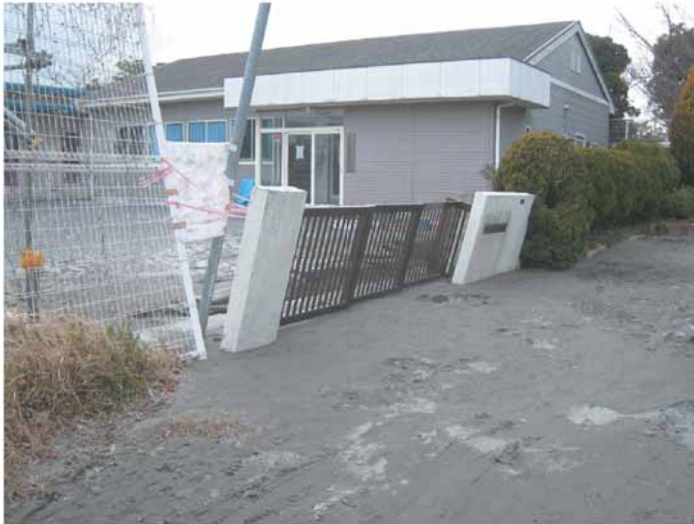
(a) 噴き出した砂と傾いた門
