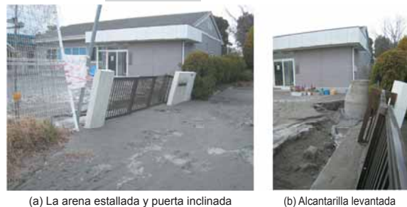
Foto 1. Daño por licuefacción (ciudad de Urayasu)
