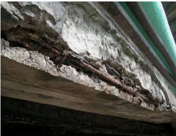
塩害で劣化した橋を下から見たところ
