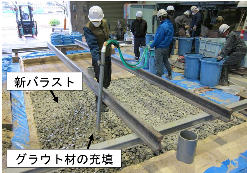
図1.4.2 グラウト充填路盤改良工法（新品バラスト方式）のグラウト充填状況
